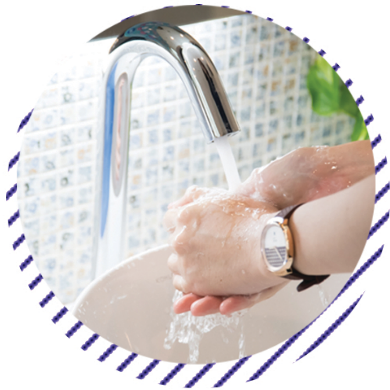
ดำเนินการติดตั้งก๊อกน้ำอัตโนมัติ สำหรับอ่างล้างมือในห้องน้ำ จำนวน 33 อัน
